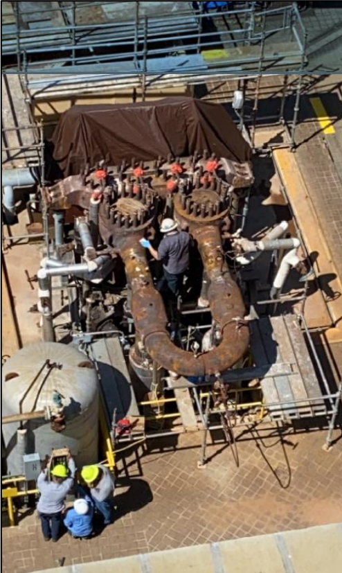
Tubo en U de la Turbina
